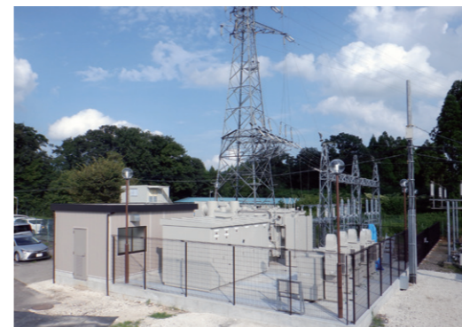
完成した伊賀工場特高受電所(2022年8月)
