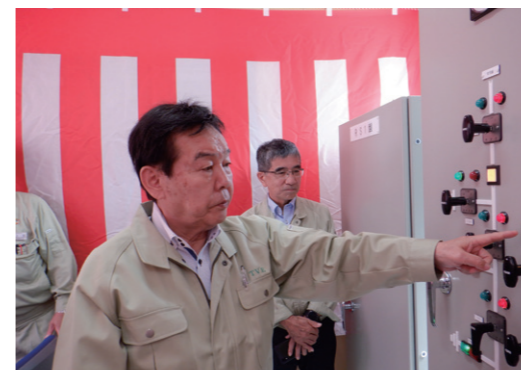
伊賀工場特高受電所の完成式で起動スイッチを押す笹野社長(2022年8月)
