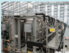
写真：多核種除去設備「ALPS」（福島県提供）
